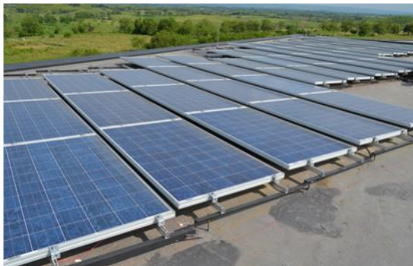
Inelta LTDA - Pereira. 14 kWp
