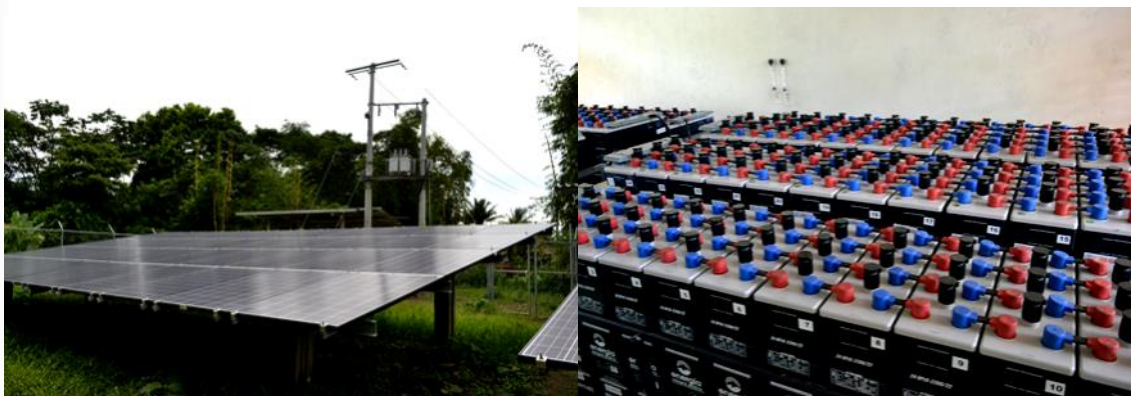
Sistema Híbrido solar diésel, 72 KWp, Punta Soldado, Buenaventura
