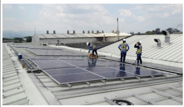
Instalación realizada para HYBRYTEC.
