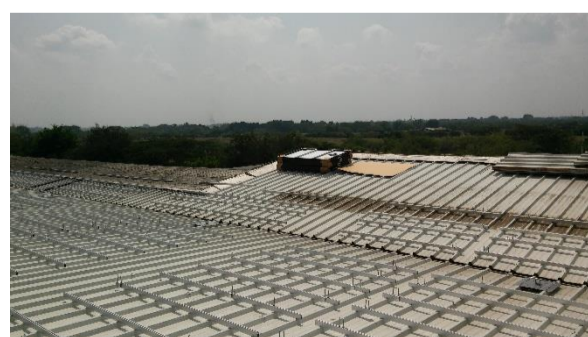
37 KWp instalados sobre cubierta metálica
