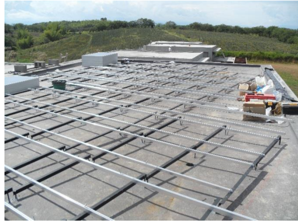
13 KWP Cerritos, Pereira
