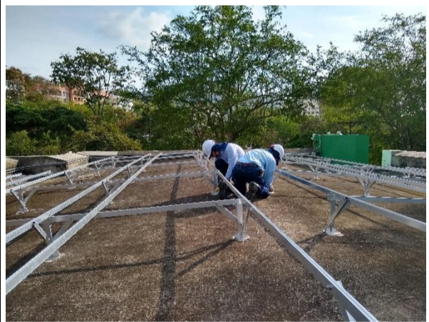
14.5 KWp sobre estructura aluminio sobre losa
