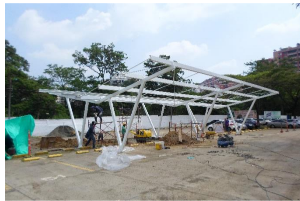
32 KWp sobre estructura pérgola metálica
