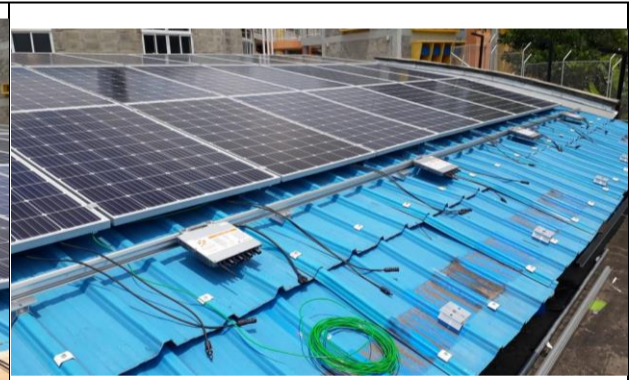
11 KWp con micro inversores (trifásico)
