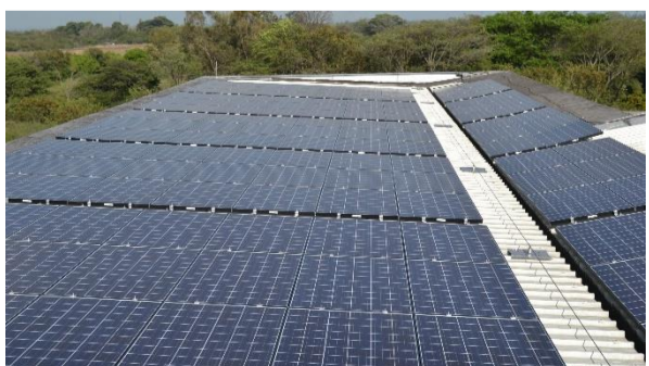
DATECSA. Instalación Industrial
