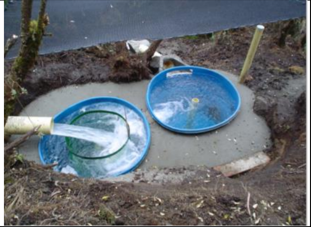
Energía eléctrica para el refugio ubicado a 4000 metros de altura sobre el nivel del mar.
