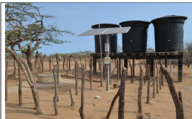
Sistemas de bombeo solar y manual para la alta Guajira, 42 comunidades. Junio 2016
