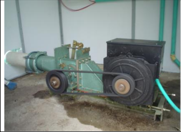
PNN Nevados. Refugio del Cisne. Turbina hidráulica de 8 KW, Noviembre 2006
