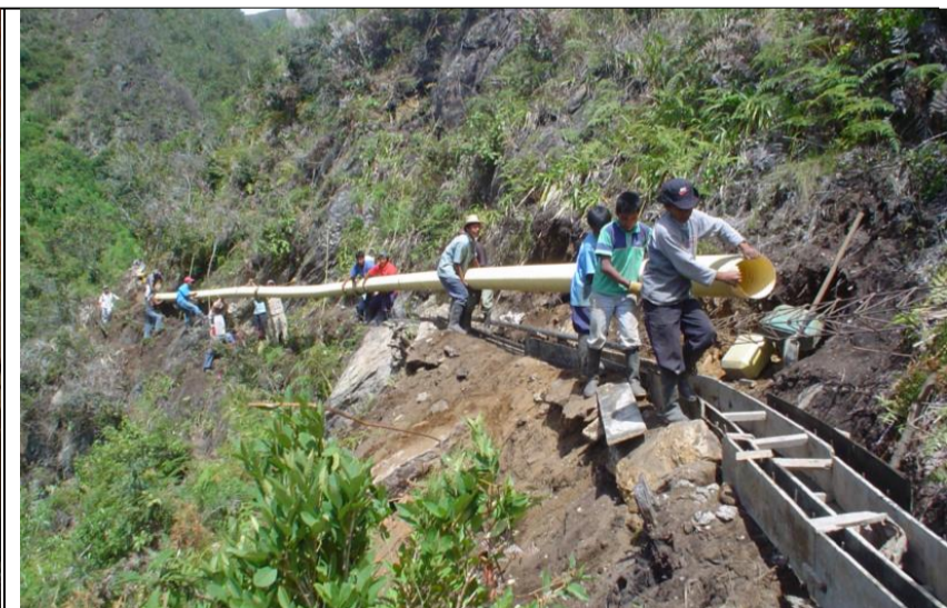
Turbina hidráulica 30 KW para energización de vereda de 35 viviendas. Proyecto construido con activa participación de la comunidad.
